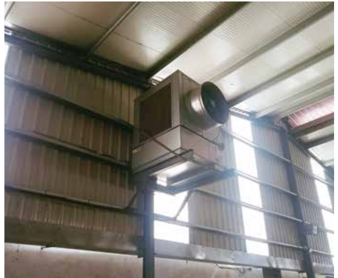
Ventilador en alojamiento
