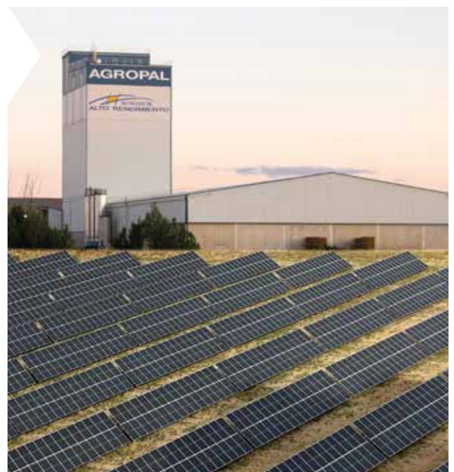
Placas solares en la planta de Nutrición de Alto Rendimiento
